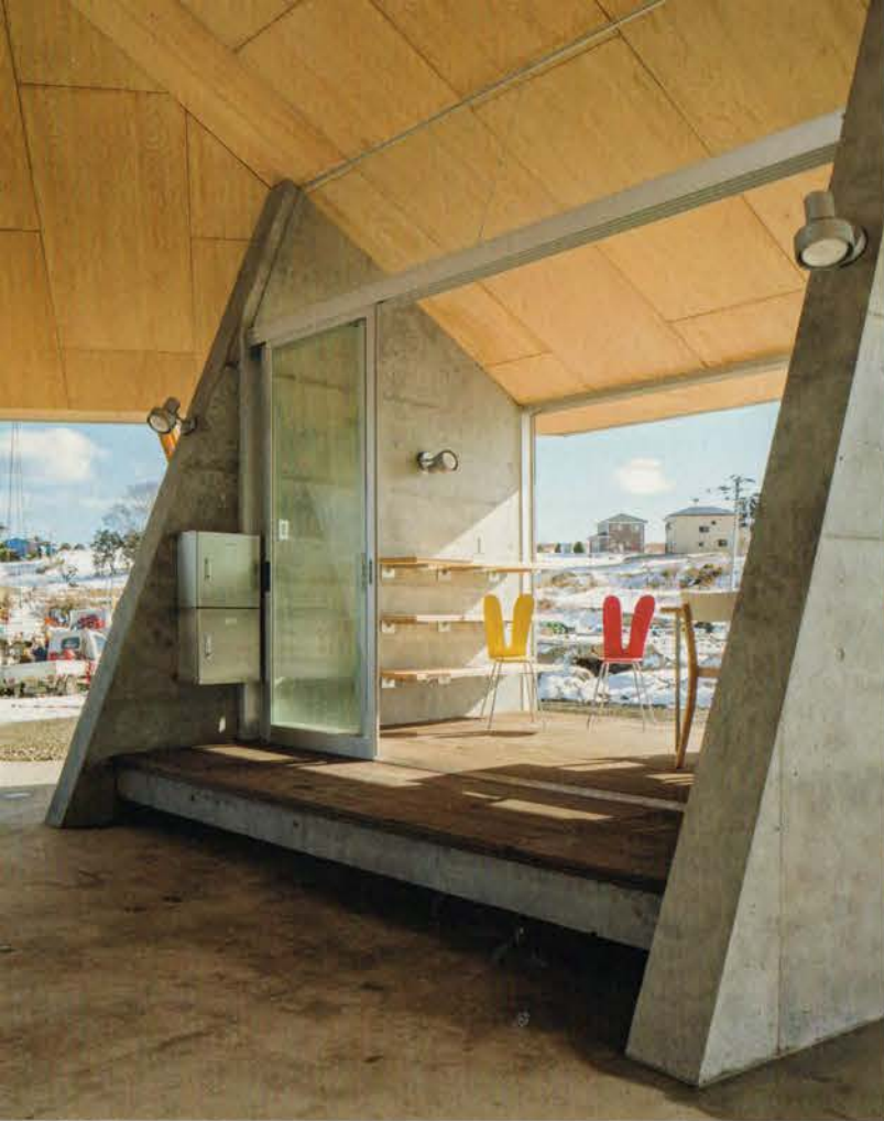
休憩所を見る。左右2面に配置された鉄筋コンクリートの壁により屋根を支える。
